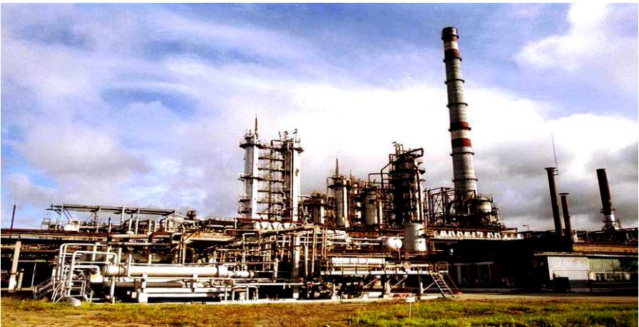
Рисунок 17 - Комбінована установка ЕЛЗУ-АВТ на Лисичанському НПЗ («ТНК-ВР»)
